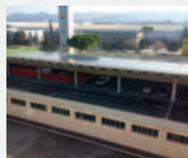
Impianto fotovoltaico da 198 kWp sul tetto dell'autorimessa del Centro Direzionale Esagono di Banca Popolare di Ancona a Jesi
